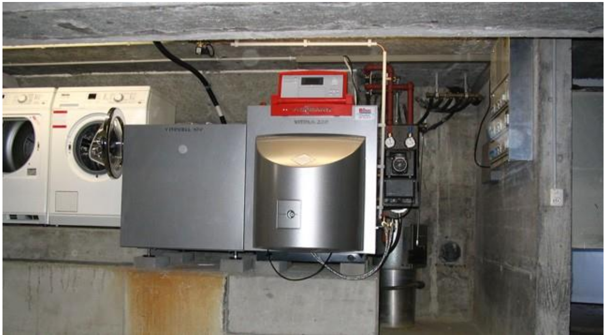
Erhöht eingebaute Waschmaschine und Heizung
